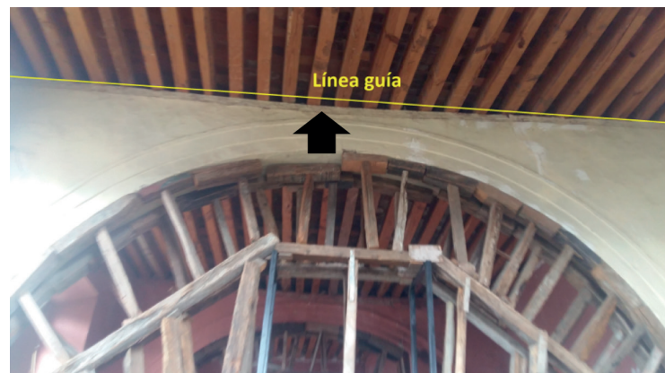
Figura 10. Deformación actual del arco en la clave. Fuente: Hadad, 2016.
