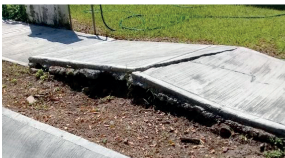
Figura 8. Banqueta deteriorada dentro del fraccionamiento. Fuente: Archivo del autor.
