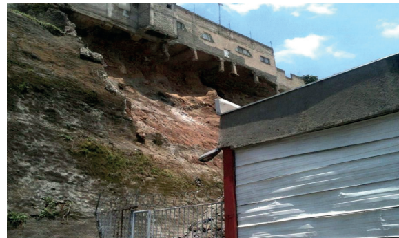
Imagen 2. Construcciones de alto riesgo, Huixquilucan, Estado de México. Fuente: Repositorio Fotográfico UAEMex, 2017.
