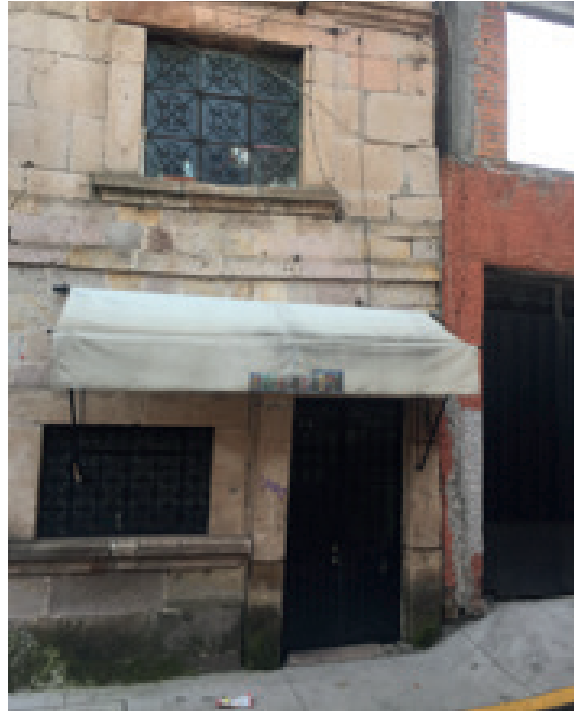
Figura 8. Diferencia de nivel y grieta en colindancia de viviendas. Calle Alberto Alvarado. Fuente: Archivo propio.
