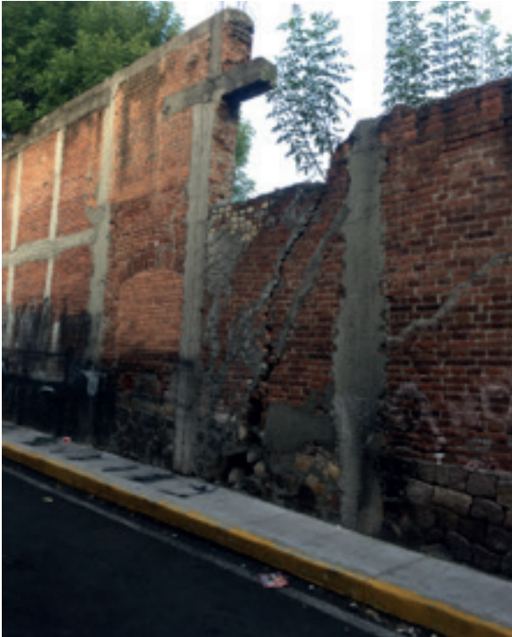
Figura 7. Fractura por desplazamiento en muro oriente, Antigua planta Tron Hermanos. Fuente: Archivo propio.
